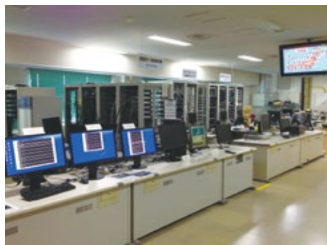
テレメータ装置室、ここに日本各地の地震観測記録や地殻変動連続観測記録が オンライン・オフラインで集まる The telemeter room: Online and offline data from observation networks for earthquakes and crustal deformation are processed
